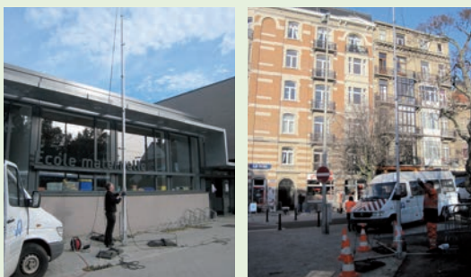
Figuur 5 – Voorbeelden van installatie van een videocamera op een mast (bron: OCW)
