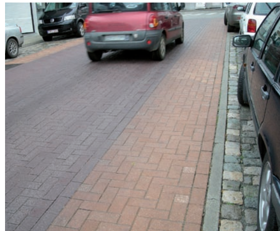
Betonsteenbestrating draagt bij aan een begrijpelijk wegbeeld
