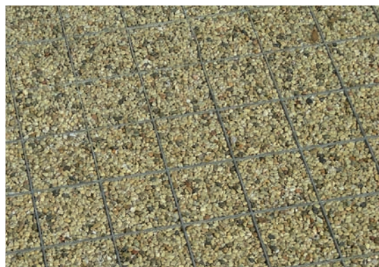
Doorlatende constructie met synthetische honingraatplaten en grind voor de Amerikaanse ambassade in Brussel
