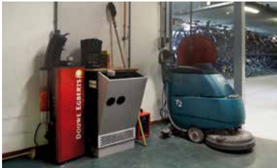
Amsterdam : Matériel de nettoyage.
