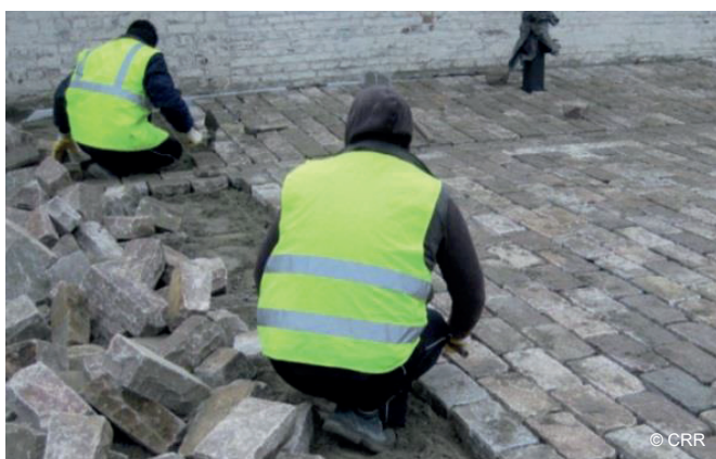
Nichage des pavés dans la couche de pose
